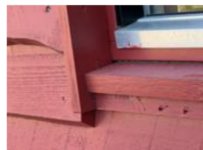
Dårlig løsning rundt lister/vannbord
