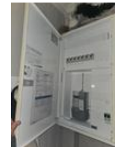
Sikringskap med automatsikringer og kursfortegnelse
