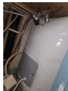
Varmtvannstank i en innredning på badet
