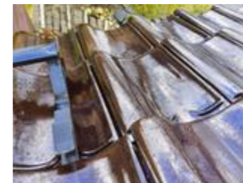
Enkelte mindre slitasjeknaster på taksteinen
