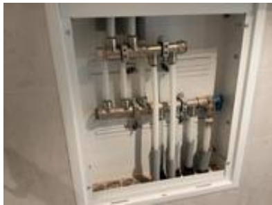
Fordelingskap for tappevann
