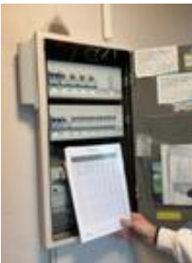
Sikringsskap med automatsikringer og kursfortegnelse
