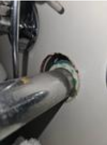
Utettheter ved gjennomføring i vegg, våt sone
