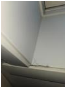
Utforingen på det ene takvinduet har en fuktskade
