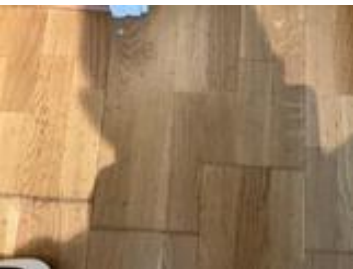
Bruks slitasjer på gulvet
