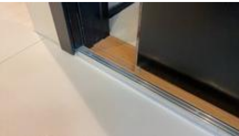
Liten spalte mellom terskel og dørbblad.
