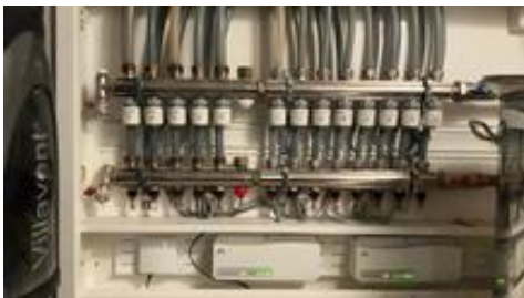
Vannskap for gulvvarme.
