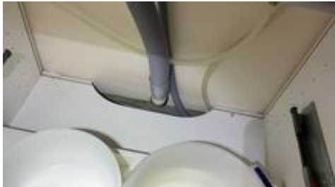
Synlig duk ført opp på vegg, men ufullstendig utførelse,
