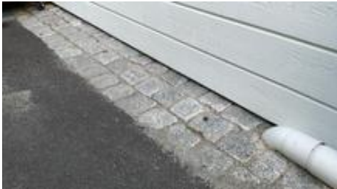
Liten avstand mellom kledning og bakke.
