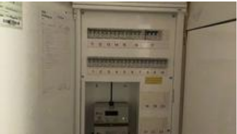
Sikringsskap med automatsikringer.
