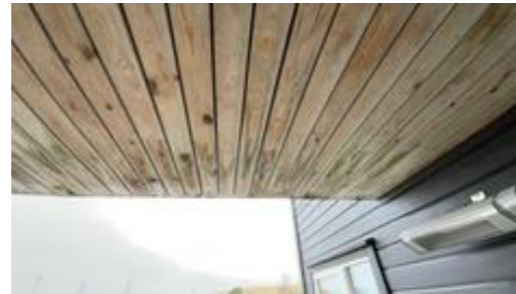
Fuktmerker i trepaneler i underkledning under balkong.
