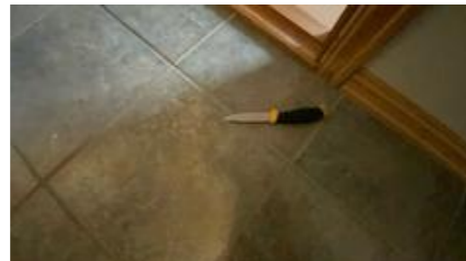
Det er påvist "bom" i/under enkelte fliser på gulv i entre/gang i underetasje.
