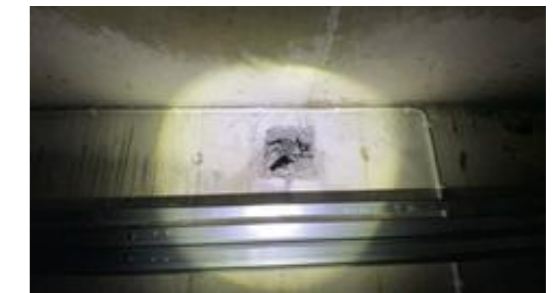
En ventil er tilnærmet tett. Kan se ut som om den har kollapset ved støping av vegg.
