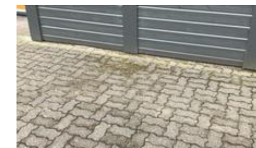
Liten avstand kledning/terreng ved inngangsparti.
