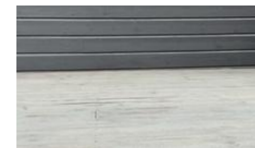
Liten avstand kledning/terrasse.
