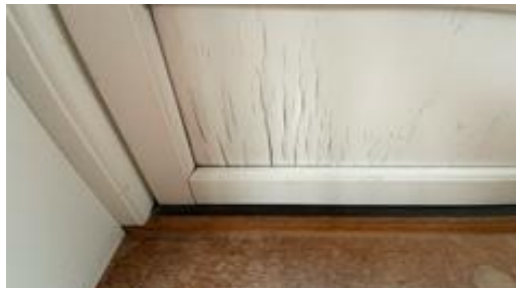
Balkongdør i 2. etasje har merker som tyder på at fukt har trukket gjennom døren.
