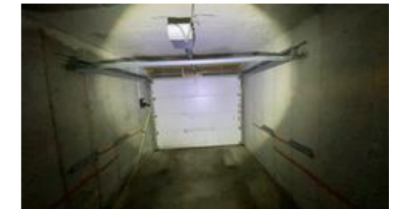
Garasjerom er begrenset ventilert.
