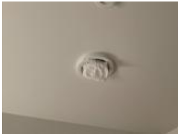
Bildet viser funksjonstest av avtrekket som er gjennomført med papir og vurdert som tilfredsstillende.
