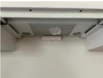
Bildet viser funksjonstest av avtrekket som er gjennomført med papir og vurdert som tilfredsstillende.
