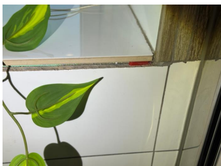
Manglar tetting ved karn til vindauge, like ved dusjnisse. Usikkert om det er nytta tettesjikt bak fliser i dette området. Bør kontrollerast nærmare.
