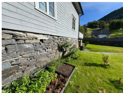
Turrmurt har naturlege "sprekker og riss" dette kan føre til tilkomst av skadedyr. Ein bør vurdere puss og tetting av grunnmur der dette kan ver eit problem.
