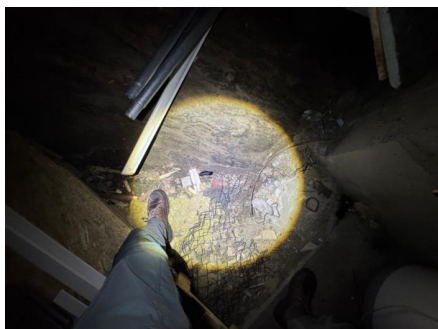
Skadedyr ved synfaring.
