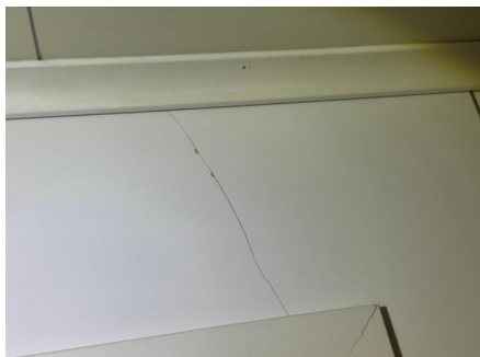
Sprekk i flis over dør.
