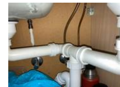
Røropplegg i skap under vask
