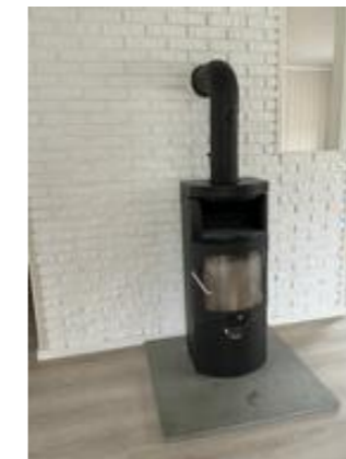
Vedovn i 2. etasje
