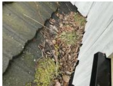
Tak tekket med decra. Det vil være behov for vedlikehold og rens av «renner».
