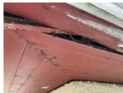
Råteskader i takutstikk.
