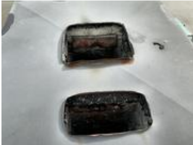
Manglende toppavdekning over pipe.
