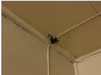
Ledninger/koblinger uten deksel/koblingsboks.
