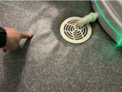
Løst belegg på gulv.
