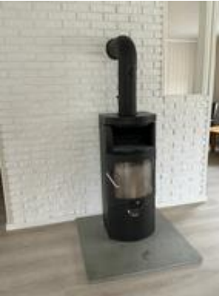
Vedovn i 2.etasje
