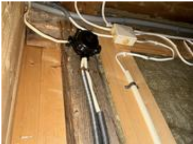
Koblingsboks med innhold av asbest.
