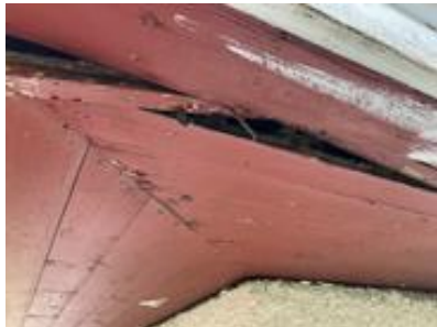
Råteskader i takutstikk.
