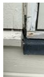
Det er registrert utett fug ved vindu i stue.
