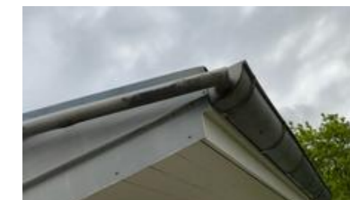
Lekkasje fra overgang nedløpsrør.
