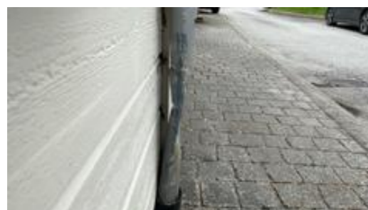
Nedløpsrør er klemt sammen.
