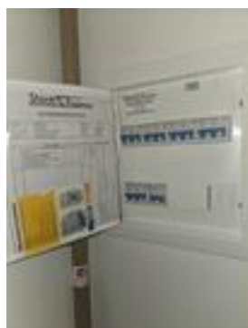
Sikringsskap med automatsikringer og kursfortegnelse
