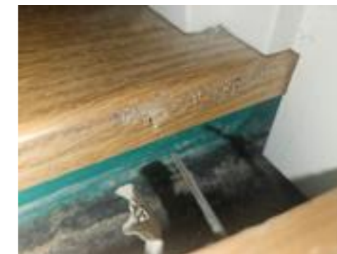
Oppkant under døra
