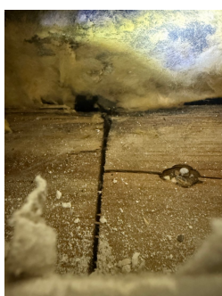
Trevirke/svill med synlige fuktskader
