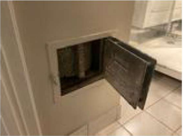
Sotluke med sotlukestein
