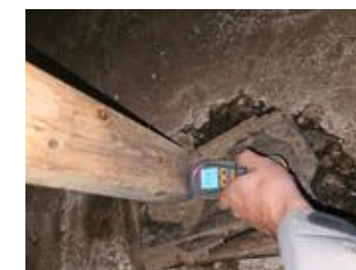
Høyt fuktnivå i nedre del av søyle under bjelkelaget
