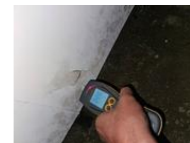
Høyt fuktnivå i platekledning på vegg
