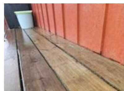
Det er ikke beslag i overgang verandadekke / yttervegg
