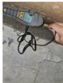
Høyt fuktinnhold i bunnsvill i yttervegg sør
