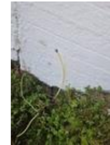
Det ligger et vannrør frem til grunnmuren. Ikke tilkoblet
