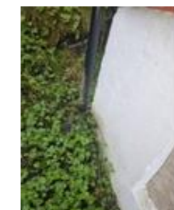
Takvannet ledes til terrenget ved grunnmuren
