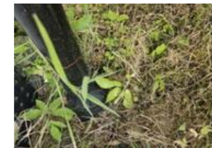
Takvannet ledes til rør i grunnen
