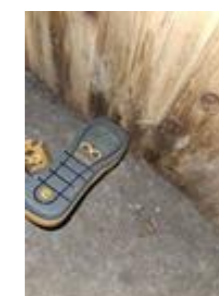
Høyt fuktnivå i panel på vegg
