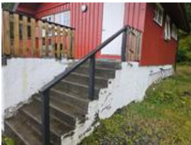
Åpningene i rekkverket er for store
