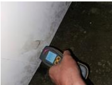
Høyt fuktnivå i platekledning på vegg
