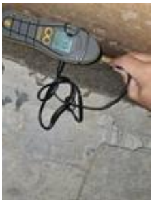
Høyt fuktinnhold i bunnsvill i yttervegg sør
