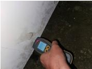
Høyt fuktnivå i platekledning på vegg
