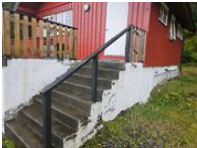
Åpningene i rekkverket er for store
