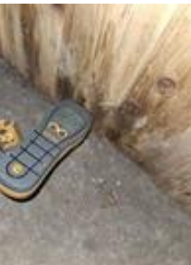
Høyt fuktnivå i panel på vegg
