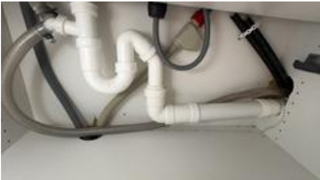
Røropplegg i kjøkkenbenk
