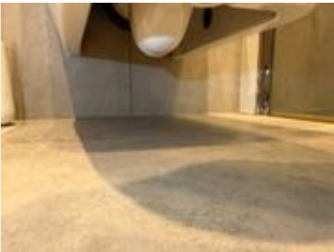
Manglende hull/lekkasjevarsler under wc
