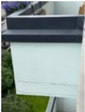
Oppsprekket puss utvendig på balkong.
