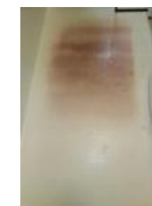
Misfarget gulvbelegg på badet
