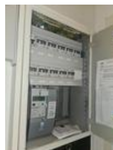
Sikringskap med automatsikringer
