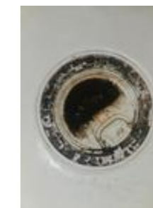
Gulvbelegget er klemt mot en plastsluk i gulvet
