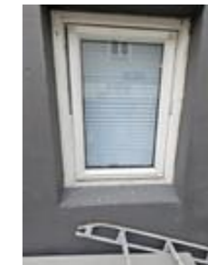
Det er ikke beslag under vinduene i fasade vest
