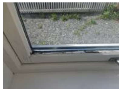
Sverte etter fukt og kondens, vindu bad
