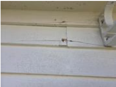
Det er påvist oppstrekt panel på utvendig kledning.
