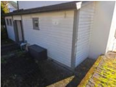
Det er påvist råteskader i den liggende bordkledningen, samt slitasje og avflassing av overflatebehandling.
