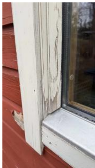
Eksempelbilde av slitasjegrad på stuevindu.
