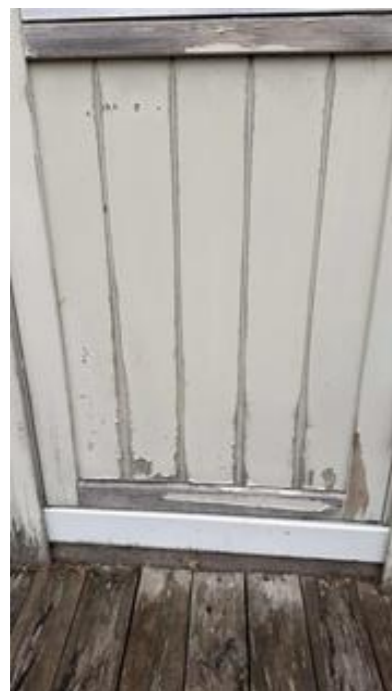
Eksempelbilde av slitasjegrad på terrassedør på stue.
