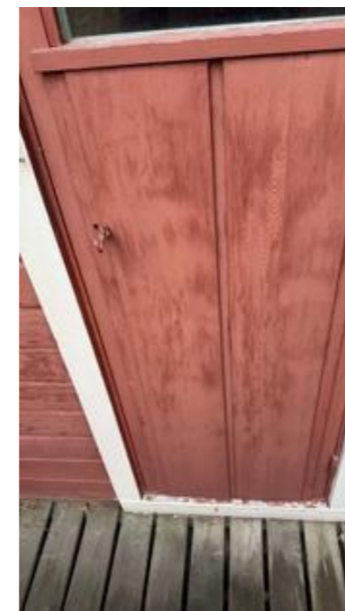
Eksempelbilde av slitasjegrad på balkongdør.
