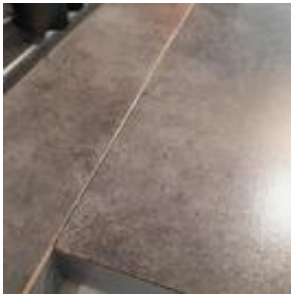
Svelling ved skjøt på benkeplate.
