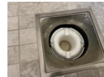
Sluk i dusjsonen
