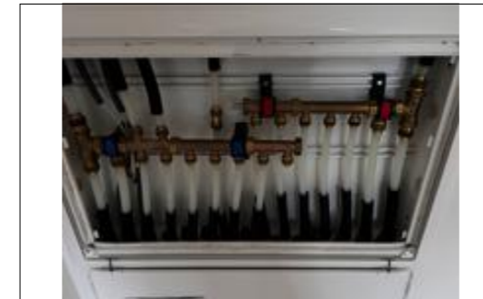
Fordelerskap i kjeller.
