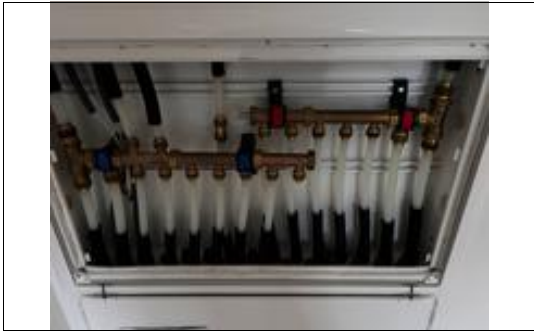
Fordelerskap i kjeller.
