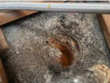
Rusta sluk frå byggeår
