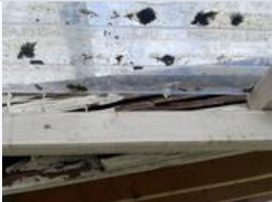
Råte i sperr over ytterdør til underetasjen
