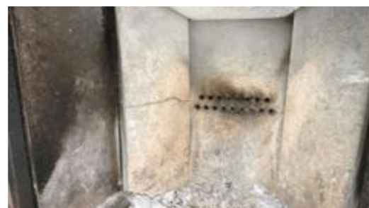
Sprekker i ildfast stein inni vedovn i kjeller.
