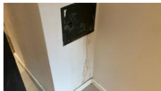
Merker etter sotrenninger fra feieluke i kjeller.
