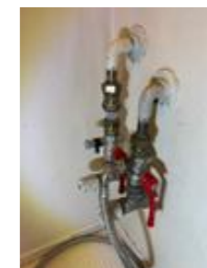
Hovedstoppekraner i toalettrom.
