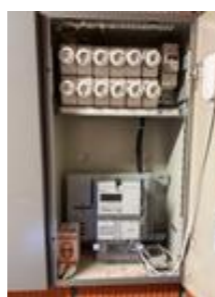
Skrusikringer med skap i felles trappegang.
