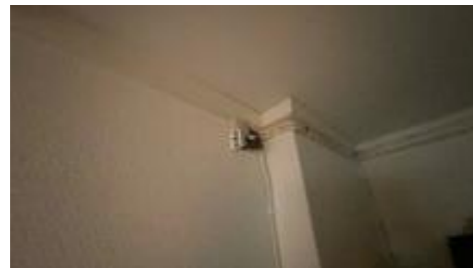
Koblingsboks mangler deksel.
