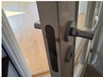
Skader på dørblad
