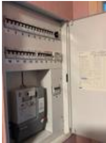
Sikringsskap med automatsikringer og kursfortegnelse, hoveddel
