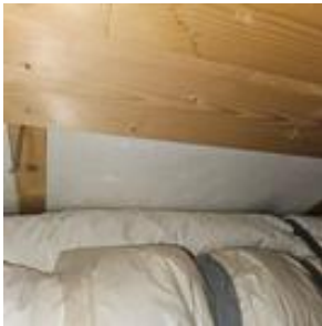
Bakre del av boden har ikke panel i himlingen. Synlig eps isolasjon her.
