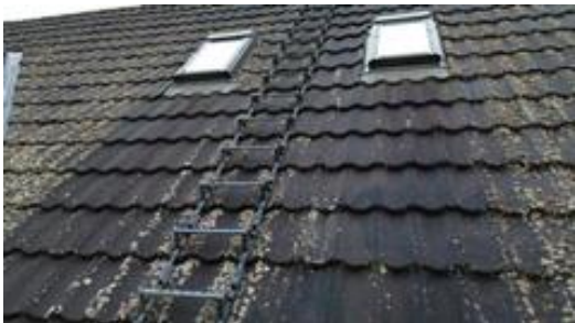
Fast monterte stigetrinn til pipen
