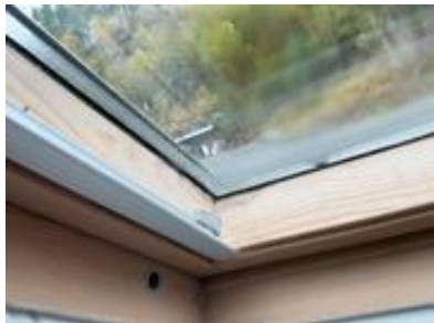
Spor etter kondens på nedre kant av rammen på et takvindu
