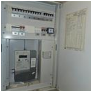
Sikringsskap med automatsikringer og kursfortegnelse, utleiedel
