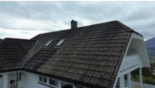
Litt mose på takside nord, bør fjernes
