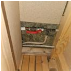
Egen stoppekran for sokkelleiligheten
