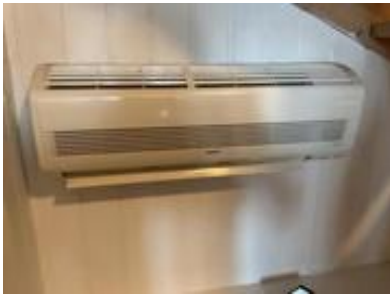
Luft til luft varmepumpe
