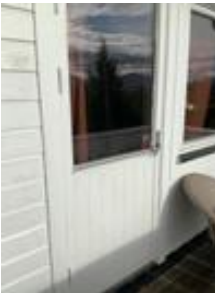
Verandadør 1 etg sør. Nedre del av dørbladet er preget av fukt.
