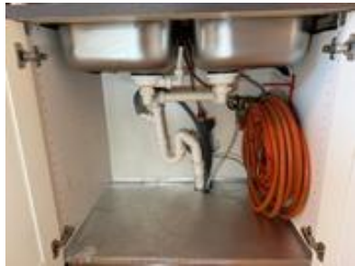
Rørapplegg i kjøkkenbenk med brannslange
