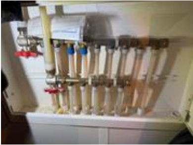
Rørskap i entre med stoppekraner
