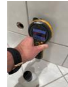
Variable utslag med fuktindikator i området rundt drenshull
