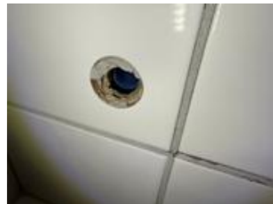
Riss i flisefuger i dusjsone ved skadested
