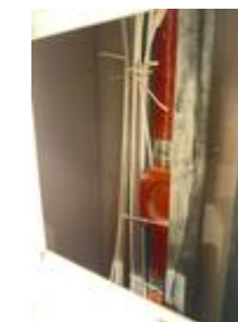
Det er avløpsrør av støpejern.
