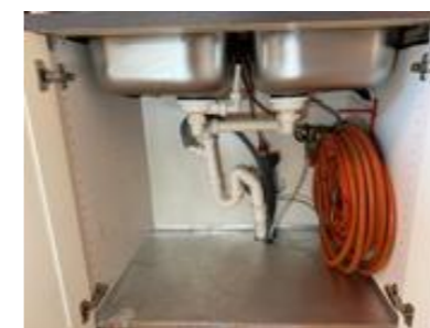
Røropplegg i kjøkkenbenk med brannslange
