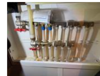
Rørskap i entre med stoppekraner
