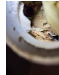
Påvist tørråte inne i deleveggen mellom bad og gang.
