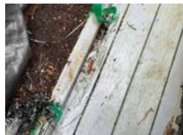
Råte i terrassebord
