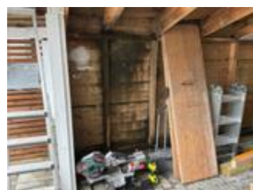
Skade i vegg, utbedres av eier før salg.
