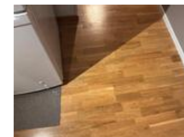
Fuktskade i parkett fra tidligere kjøle/frys med isbitmaskin.
