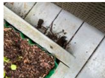
Råte i terrassebord
