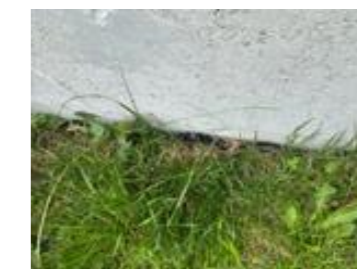
Det mangler topplis på grunnmursplaten
