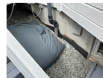
Det mangler topplis på grunnmursplaten
