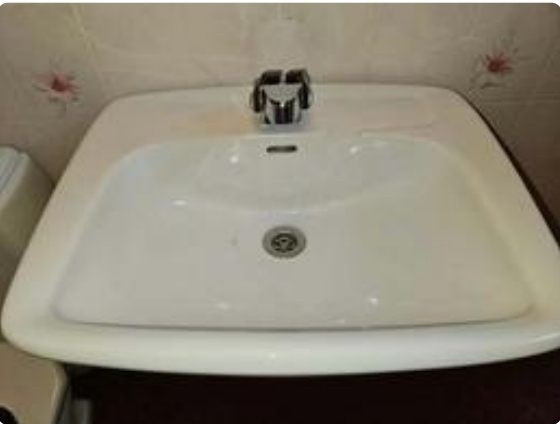
Sprekk i servant.
