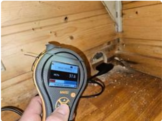
Fuktutslag i bunnramme ved hullboring i bod.
