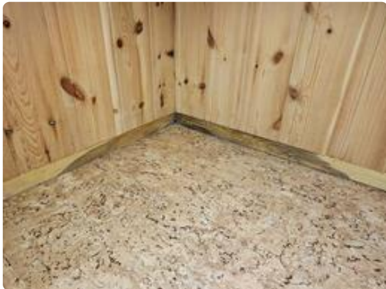
Fukt i listverk på soverom som tilstøter terreng.
