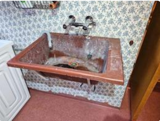
Slitasje på tapet under vask.
