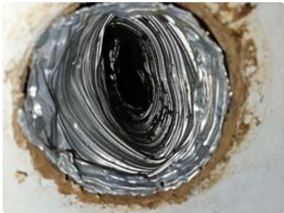
Naturlig ventilasjon via oppdrift. Ventilasjonskanal er også deformert, som begrenser gjennomstrømming av luft.
