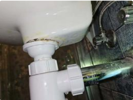
Drypplekkasje i vannlås under vask.
