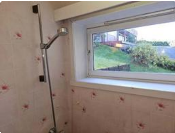
Vindu i dusjsone som er utsatt for fukt.
