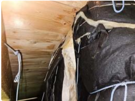
Fuktskjolder ved gjennomføring for ventilasjon.
