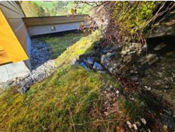
Overfltevann fra fjell er prøvd drenert bort, men det er indikasjoner på at vannet og blir ført mot grunnmur.
