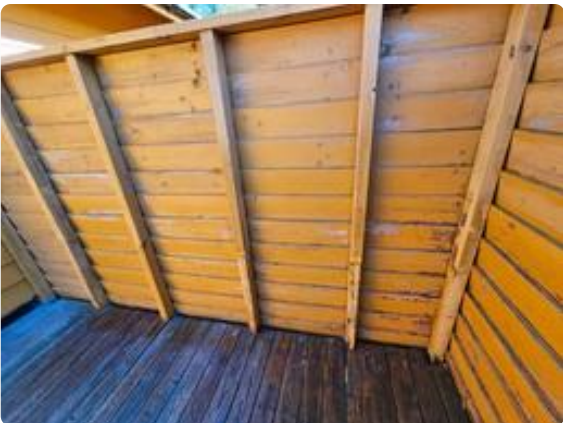
Malingflass på rekkverk og dekke
