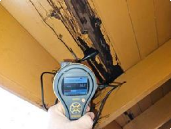
Malingflass, råte og høyt fuktutslg i undertak ved utstikk.
