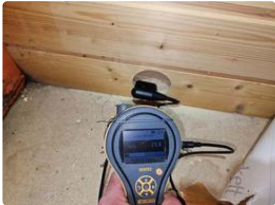
Fuktutslag i bunnramme ved hullboring i bod.
