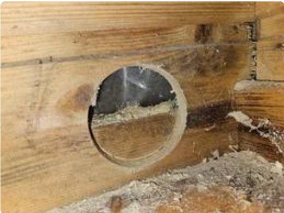
Synlige tegn på fuktpåvirkning i bod. Hullboring utført.
