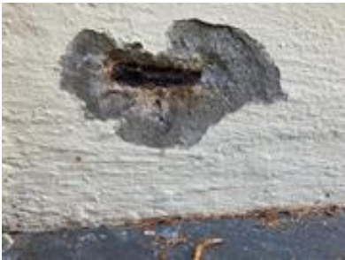
Skade i overflate mur, synling armering som er rustet
