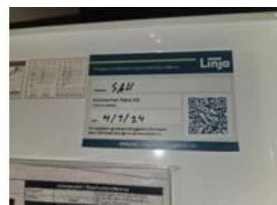
Kontrollert av eltilsynet i 2024
