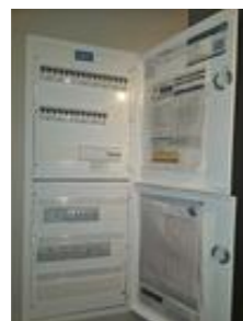
Sikringsskap med automatsikringer og kursfortegnelse
