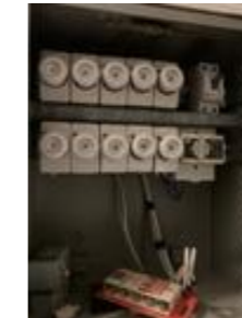
Sikringskap med skrusikringer på loft
