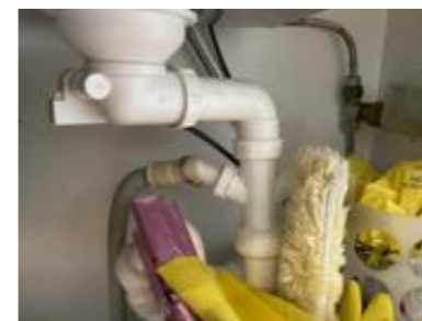
Røropplegg i skap under vask
