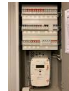
Sikringskap med automatsikringer i kjeller
