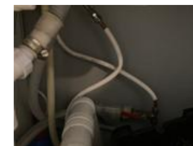
Røropplegg i skap under vask
