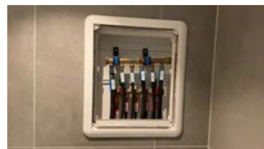
Rørskap montert i bad fra 2024.
