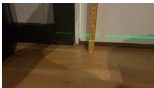
Det er målt 3,8cm på gulv på stue i kjeller.
