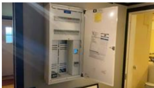
Kursfortegnelse er ikke i samsvar med antall sikringer.
