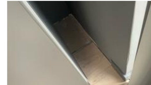
Eksempel på uferdig arbeider på soverom i 1 etasje.
