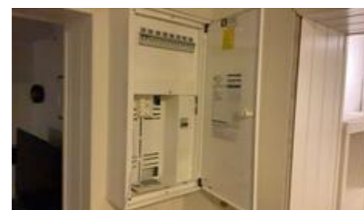
Sikringskap med kursfortegnelse i samsvar med antall sikringer.
