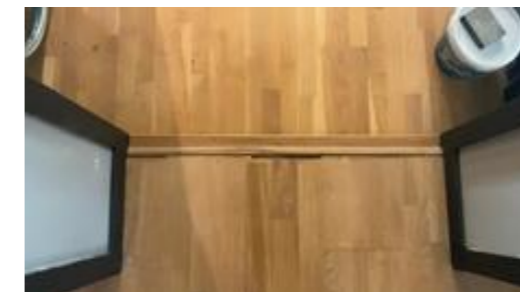
Eksempel på manglende list.
