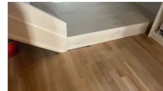
Eksempel på manglende list.
