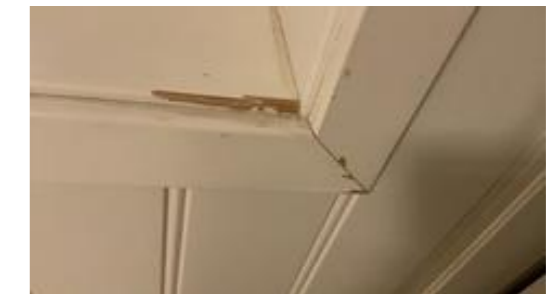
Skade på list og utforing på soverom.
