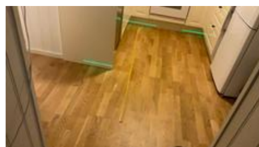
Meterstokk viser hvor avvik er registrert.
