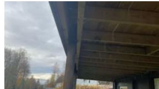
Eksempel på noe ufagmessig utførelse i bærekonstruksjoner på balkong.
