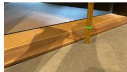
Det er målt 5,8cm på gulv ved terskel.
