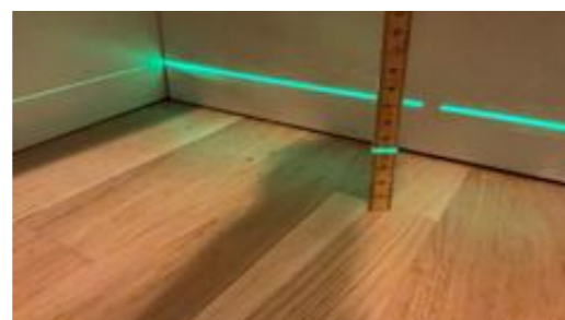
Det er målt 4,4cm på gulv ved kjøkkensokkel.
