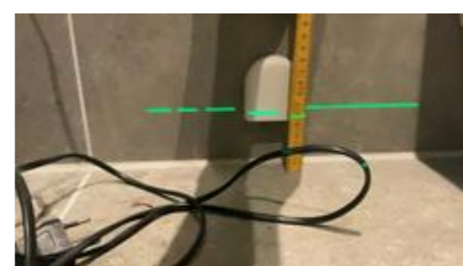
Det er målt 6cm der lekkasjevann kan oppstå fra vannskap.
