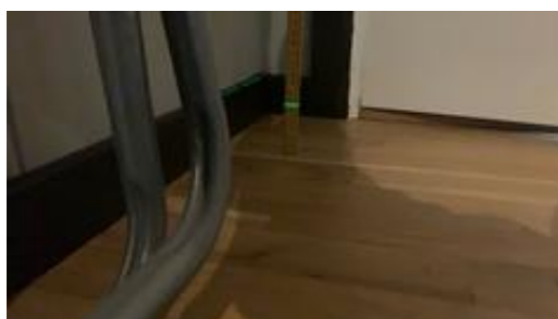
Det er målt 5,8cm på gulv i stue i kjeller.
