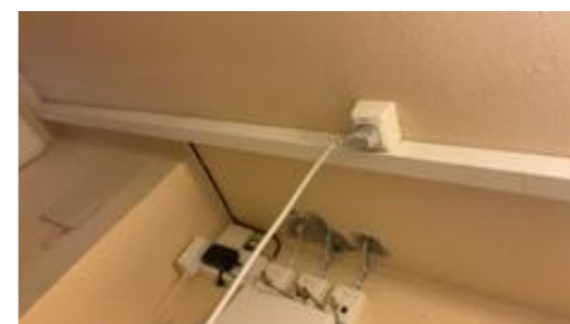
Bereder(e) er koblet via stikkontakt. Disse skal kobles direkte til strøm med bryter.
