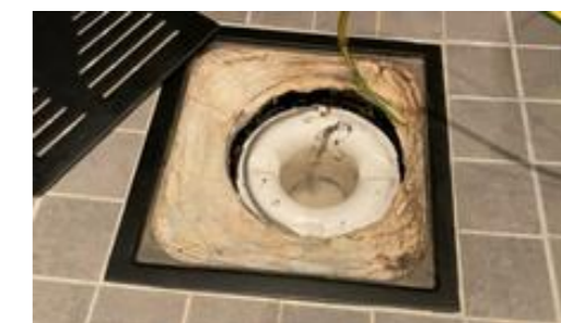
Plastsluk med synlig slukmansjett under klemring. Klemring er nedklistret med flislim.
