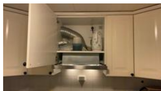
Ventilator med avtrekk ut.
