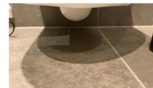
Ingen spalte under vegghegt toalett.
