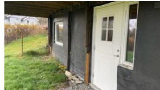
Eksempel på noe ufagmessig utførelse i bærekonstruksjoner på balkong.
