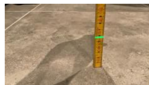
Det er målt 5,9cm ca 1,2m ifra der lekkasjevann kan oppstå. 1mm motfall er registrert utenfor dusjsonen.
