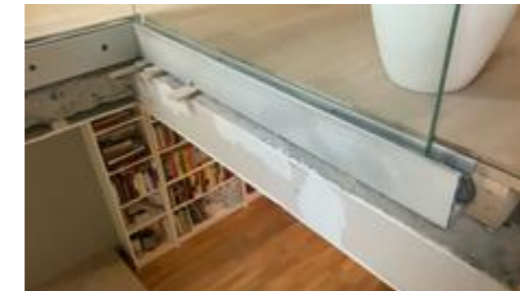
Eksempel på uferdig arbeider ved trapp.
