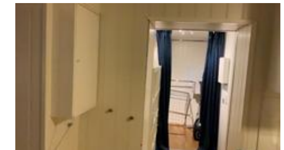
Eksempel på manglende list.
