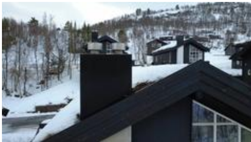
Pipetrekk av metall
