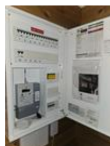
Sikringsskap med automatsikringer og kursfortegnelse
