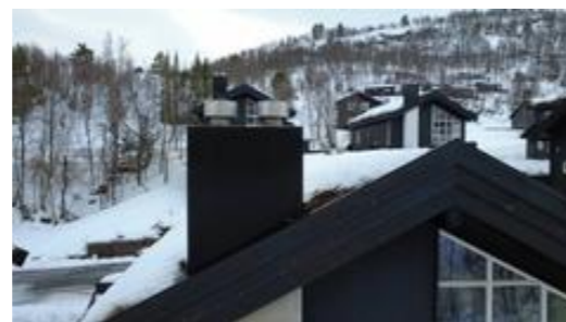
Pipetekk av metall
