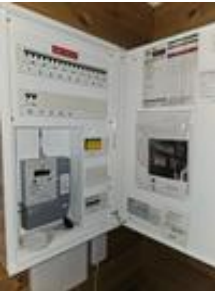
Sikringsskap med automatsikringer og kursfortegnelse
