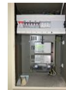
Elskap, plassert i felles trappegang.
