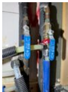
Samlestokker i rørsjakt på baderomsvegg med 2 x stoppekraner
