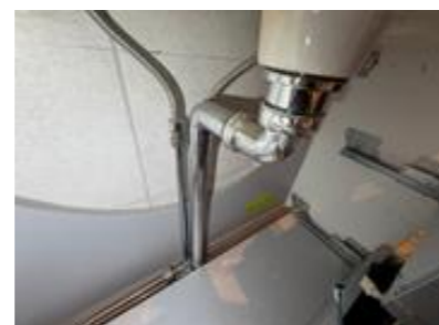
Røropplegg i servantskap
