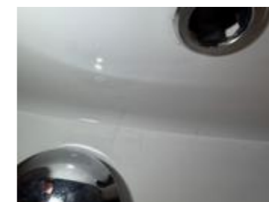
Krakkelering nede i servanten.
