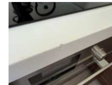
Det bemerkes 2 hakk i benkeplaten forkant.
