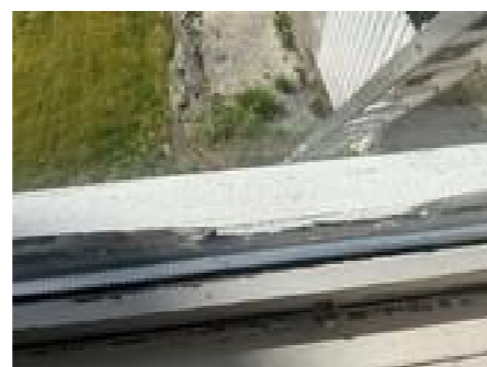
Råteskadet vindu på kjøkken
