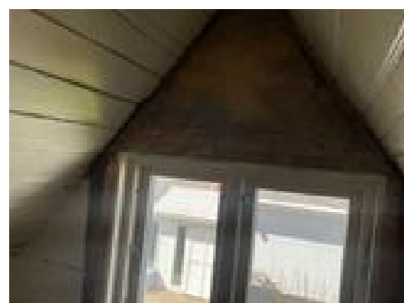
Manglende panel på vegg.
