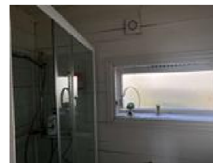
Vinduet plassert i dusjens våtsone.
