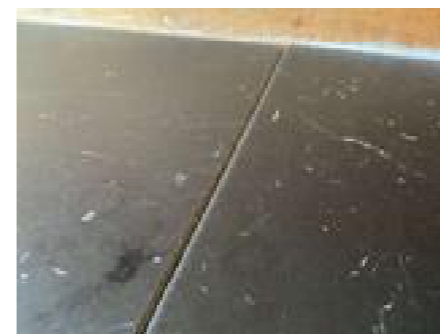
Manglende lim/fugemasse i skjøtt.
