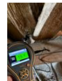
Fuktmålingen regnes som tørr og viser 15 vekt%.
