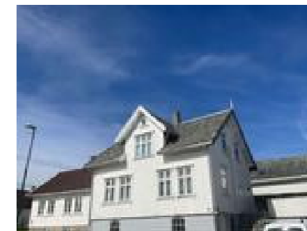
Manglende snøfanger på taket.
