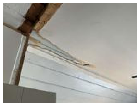
Sprekk i pappet tak.
