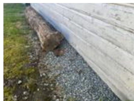
Kledning ført helt ned til terrenget.
