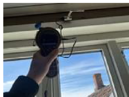
Tørr fuktmåling i råteskadet treverk.
