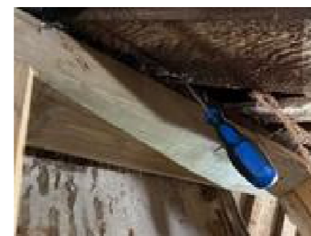
Spredt råte i undertak
