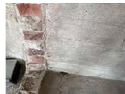
Bildet viser synlig fukt i underetasjen.
