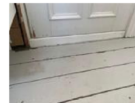
Manglende tilluftspalte under dør.
