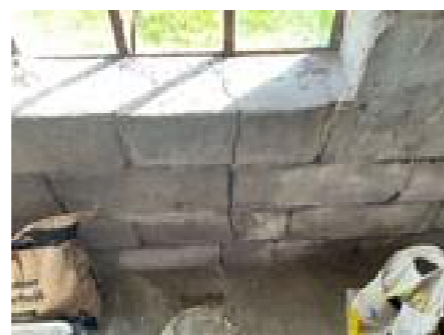
Gjennomgående sprekk i grunnmur.
