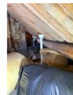
Nedbøyning i takkonstruksjonen.
