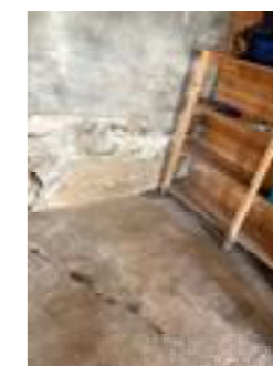
Bildet viser synlig fukt i underetasjen.
