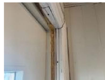
Synlig byggeskum mellom foring og listeverk.
