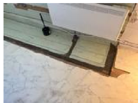
Manglende belegg på gulv
