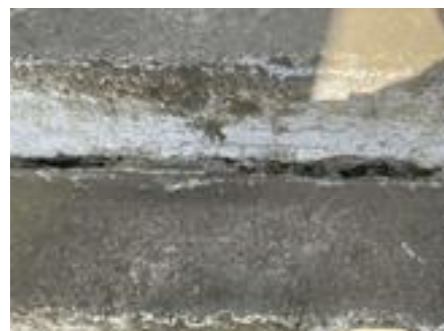
Sprekker i betong trinn.
