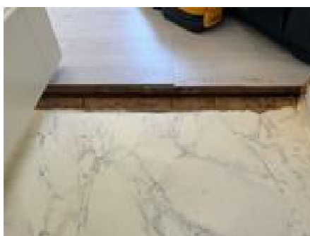
Manglende belegg oppbrett ved dør,
