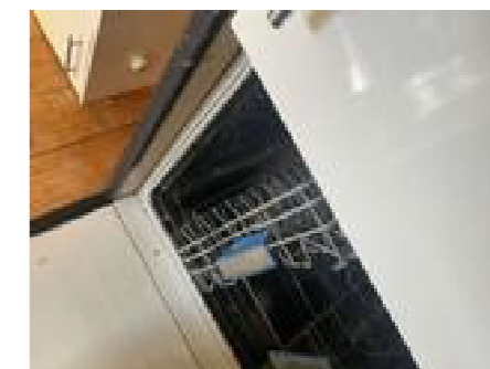
Manglende fuktsikring under benkeplate.
