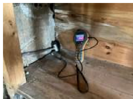
Fuktmålingen viser 25,2 vekt%.
