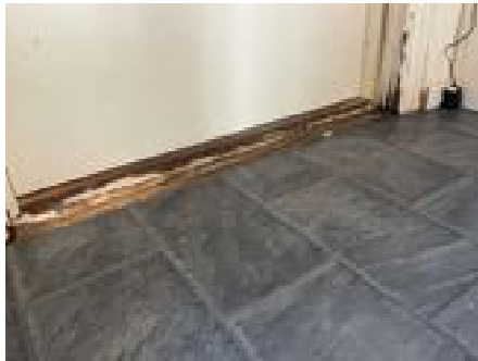
Fuktskjolder på innsiden av dør.
