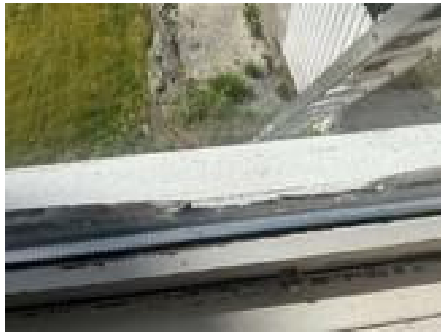
Råteskadet vindu på kjøkken
