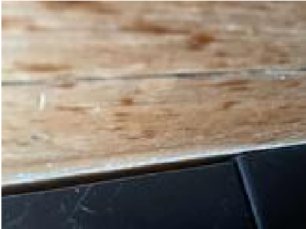
Manglende fugemasse mellom vegg og benkeplate.
