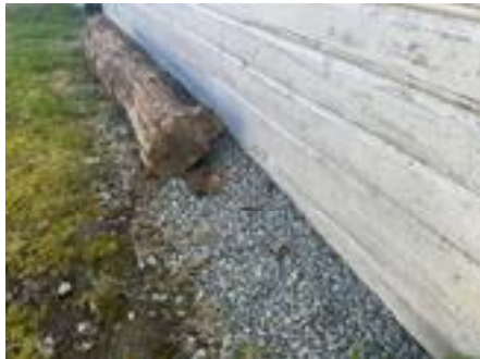
Kledning ført helt ned til terrenget.
