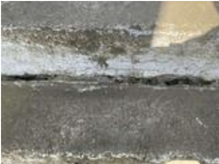
Sprekker i betong trinn.
