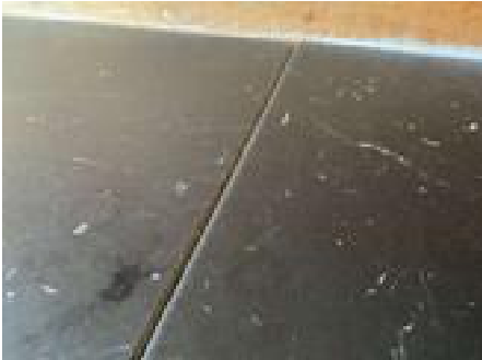
Manglende lim/fugemasse i skjøt.
