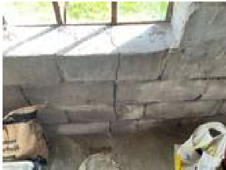
Gjennomgående sprekk i grunnmur.
