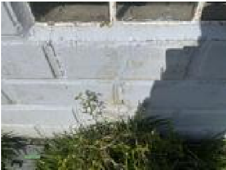
Gjennomgående sprekk i grunnmur.
