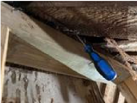
Spredt råte i undertak
