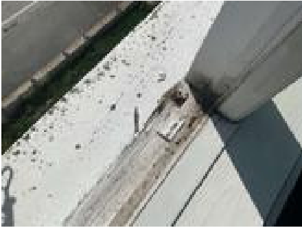
Råteskadet vindu på soverom.
