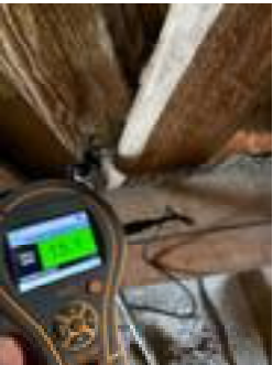
Fuktmålingen regnes som tørr og viser 15 vekt%.
