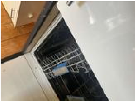
Manglende fuktsikring under benkeplate.
