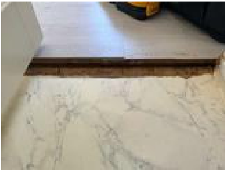
Manglende belegg oppbrett ved dør,
