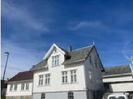
Manglende snøfanger på taket.
