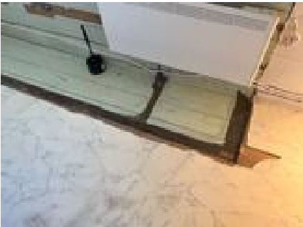
Manglende belegg på gulv
