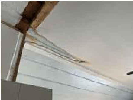
Sprekk i pappet tak.
