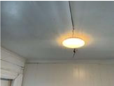
Sprekk i pappet tak.
