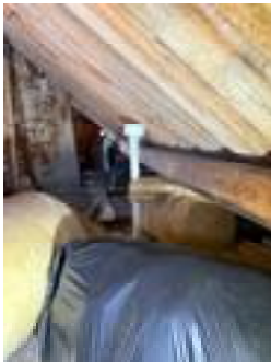
Nedbøyning i takkonstruksjonen.
