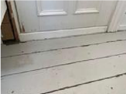
Manglende tilluftspalte under dør.
