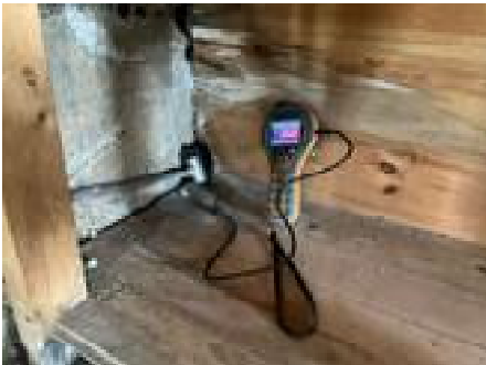
Fuktmålingen viser 25,2 vekt%.
