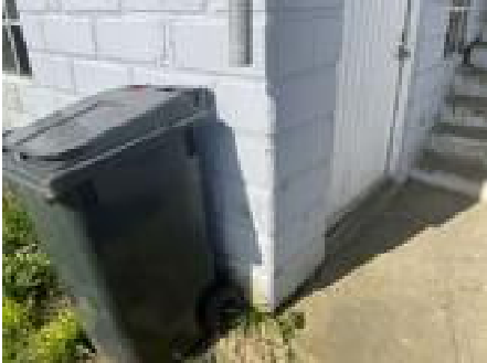
Manglende bortledning av taknedløp.
