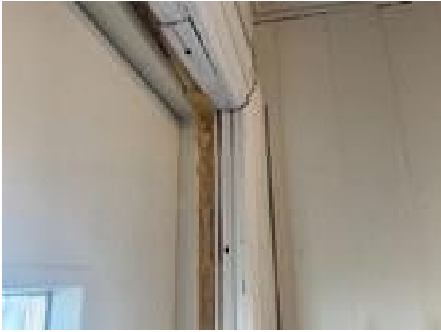
Synlig byggeskum mellom foring og listeverk.
