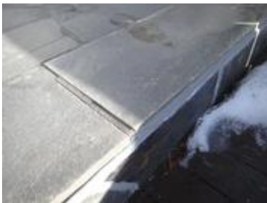
Sprekker i fuger/løsnet skifer.
