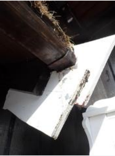
Slitasje ved vindski.
