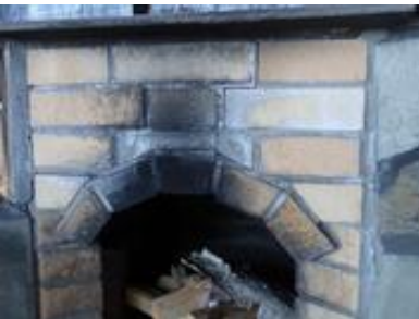
Sprekker i ildsted.
