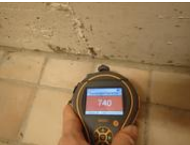
Fuktmåling på gulv.
