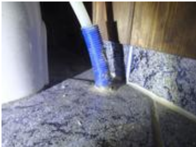
Rørføring i gulv.
