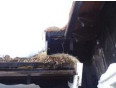
Manglende vannbord over vindskier.
