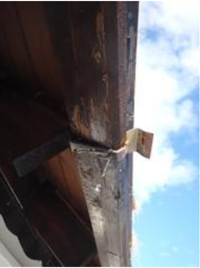
Lekkasje i renne.
