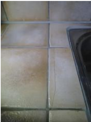
Riss/sprekk i flis.
