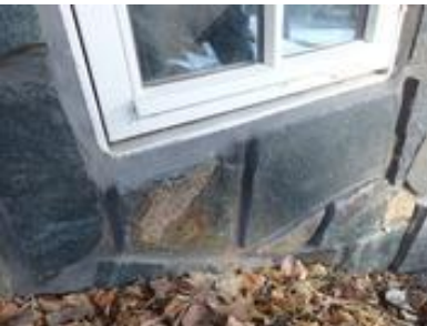
Sprekk/riss i grunnmur i venstre hjørne mot bunn av vindu.
