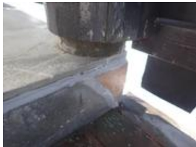
Sprekker ved fuger som er forsøkt utbedret.
