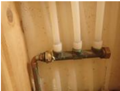
Bilde av rørfordeling.
