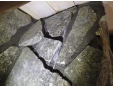
Rennemerke ved gjennomføring av pipe.
