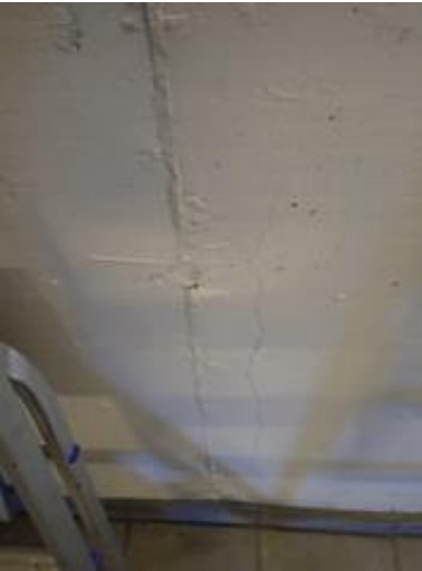
Sprekk/riss i grunnmur.
