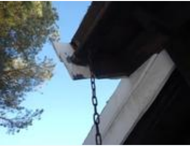
Slitasje ved vindski.
