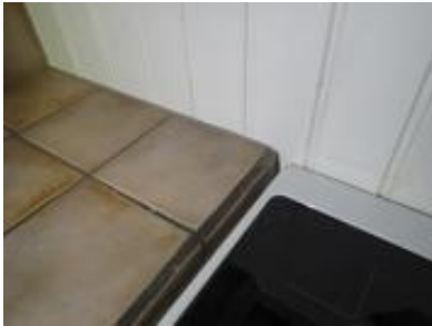
Nevnt fugekant i fremkant av benkeplate ved komfyr.
