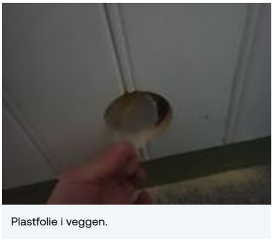
Plastfolie i veggen.
