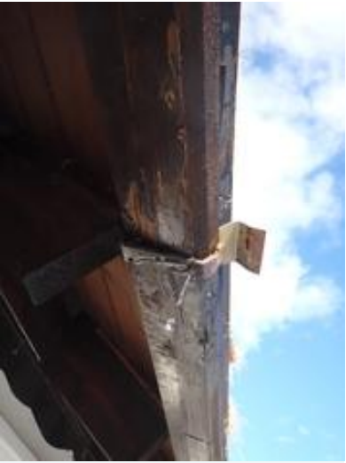
Lekkasje i renne.
