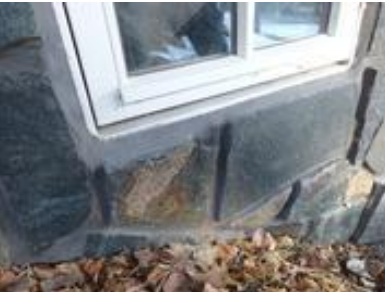
Sprekk/riss i grunnmur i venstre hjørne mot bunn av vindu.
