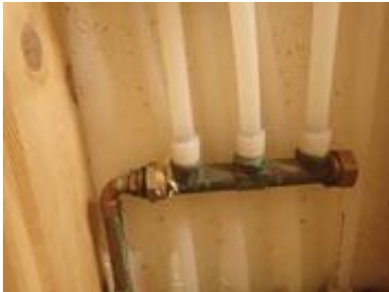
Bilde av rørfordeling.
