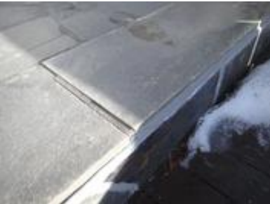
Sprekker i fuger/løsnet skifer.
