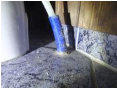
Rørføring i gulv.
