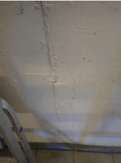
Sprekk/riss i grunnmur.
