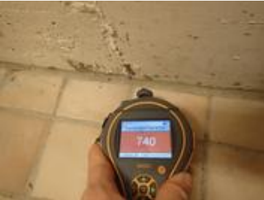
Fuktmåling på gulv.
