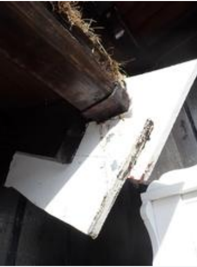
Slitasje ved vindski.
