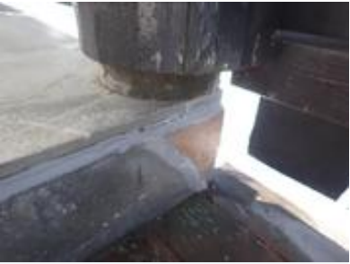
Sprekker ved fuger som er forsøkt utbedret.
