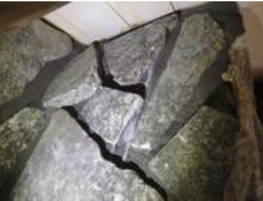
Rennemerke ved gjennomføring av pipe.
