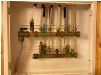
Fordelerskap for rør i rør
